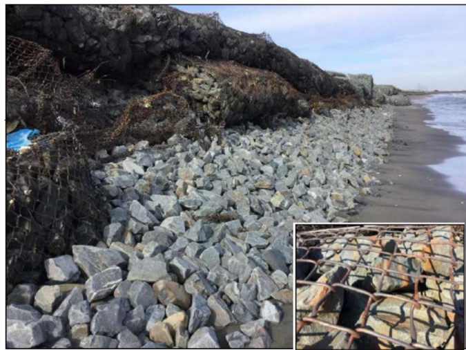
図-5 破壊されたかごマット
