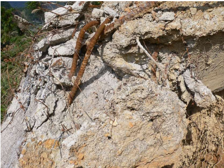
図-9 交点で折れた法枠 交点の鉄筋は赤錆だらけである。 建設後 17 年経過
