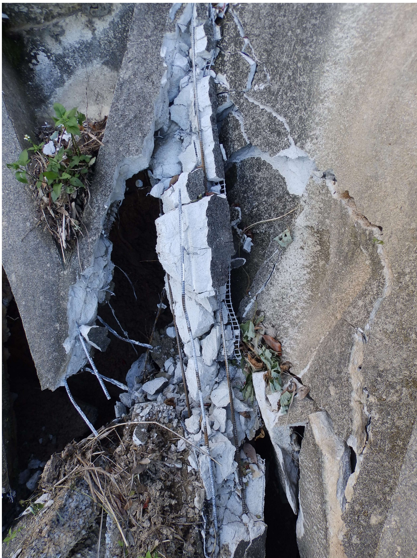
図-11 破壊された法枠の内部に見られる健全部（コンクリートがついた白色部）と錆が進行する箇所（黒褐色部）の分布状況。 建設後4年経過 鹿児島県 南大隅市内之浦町
