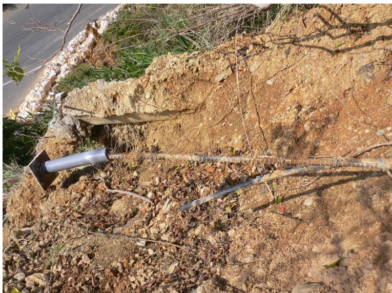
図-10 交点にあったはずの法枠が無くなり補強材のみが残る。 建設後 17 年経過
