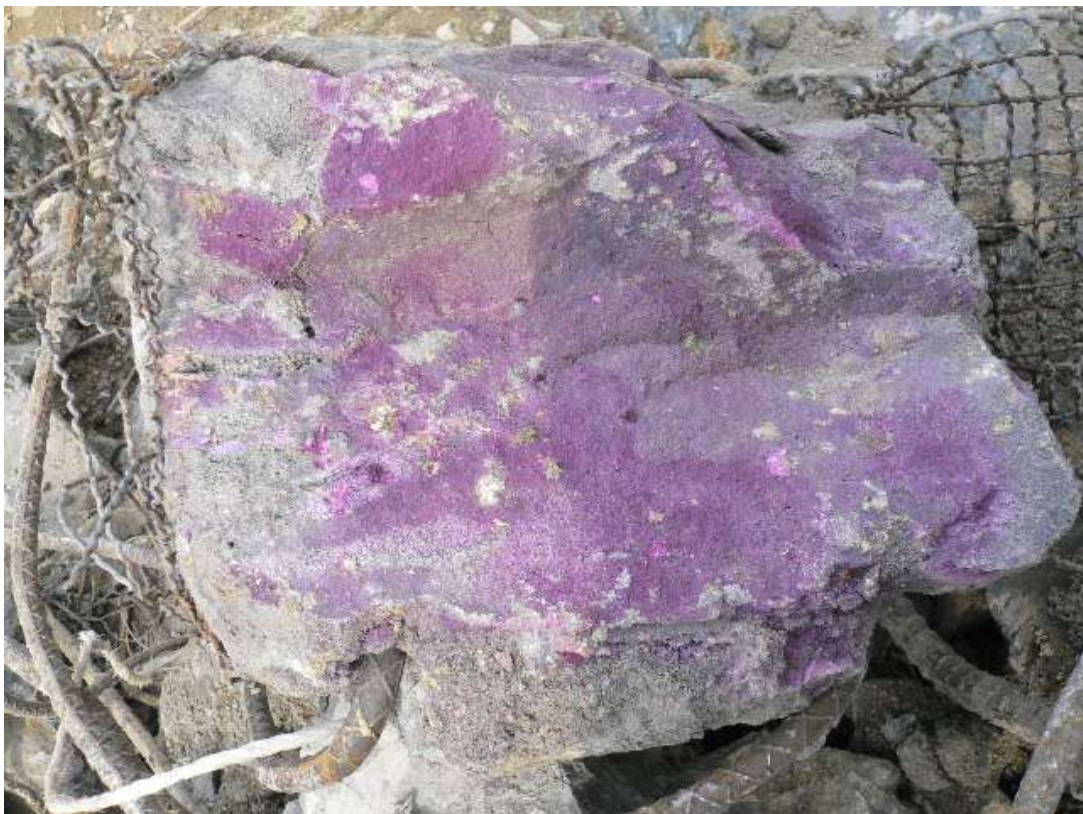
図-13 吹付モルタルの場合は、透気性が高い部分層状に形成され中性化が進行すると考えられます。この断面は調査した4断面では最も健全ですが主筋位置までは完全に中性化しています。建設後6年経過 鹿児島県 南さつま市
