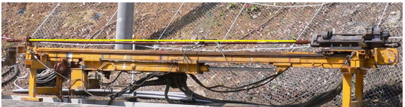
図-2 曲がっている掘削ツール 現場条件Iに使用する
