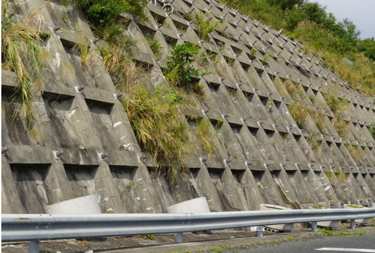
図-8 クラックが入った法枠 沖縄県 高速道路
