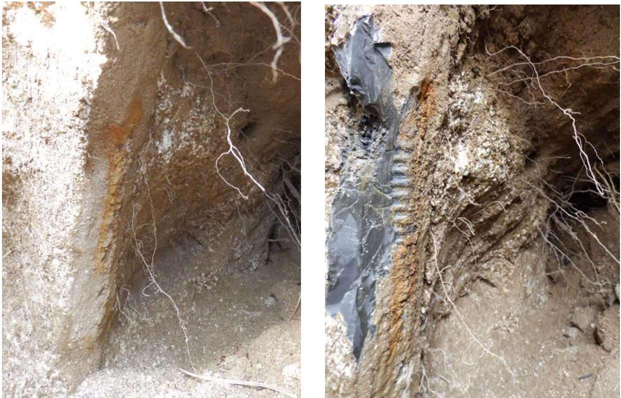
図-4 20 年経過したメッキ補強材の錆び汁とメッキ消失
