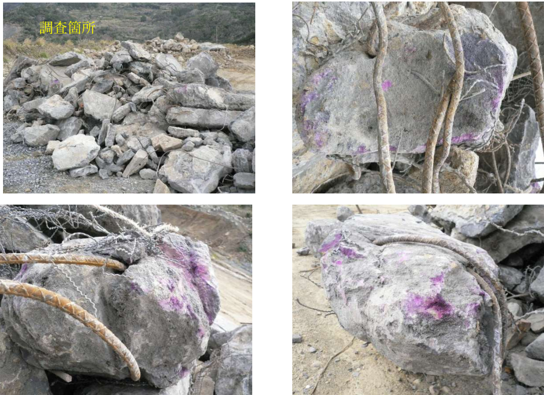
図-12 6年で中性化した法枠（梁断面で灰色の箇所）フェノールフタレイン溶液の噴霧で健全な個所は赤い色である。建設後6年経過 鹿児島県 南さつま市
